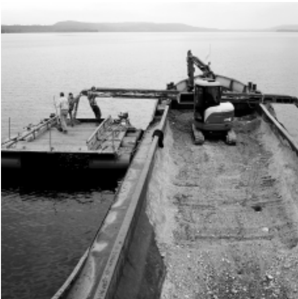
Ein Spezialfloss mit beweglichem Boden erlaubt es, Kies präzise und in dünner Schicht dort zu verklappen, wo vorher das Geotextil verlegt worden war.
